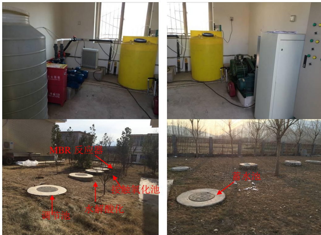
图 9-1 工程污水处理设施图
