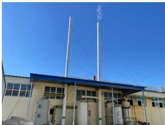
a. 浓缩结晶后处理废气排放口 (DA003)
